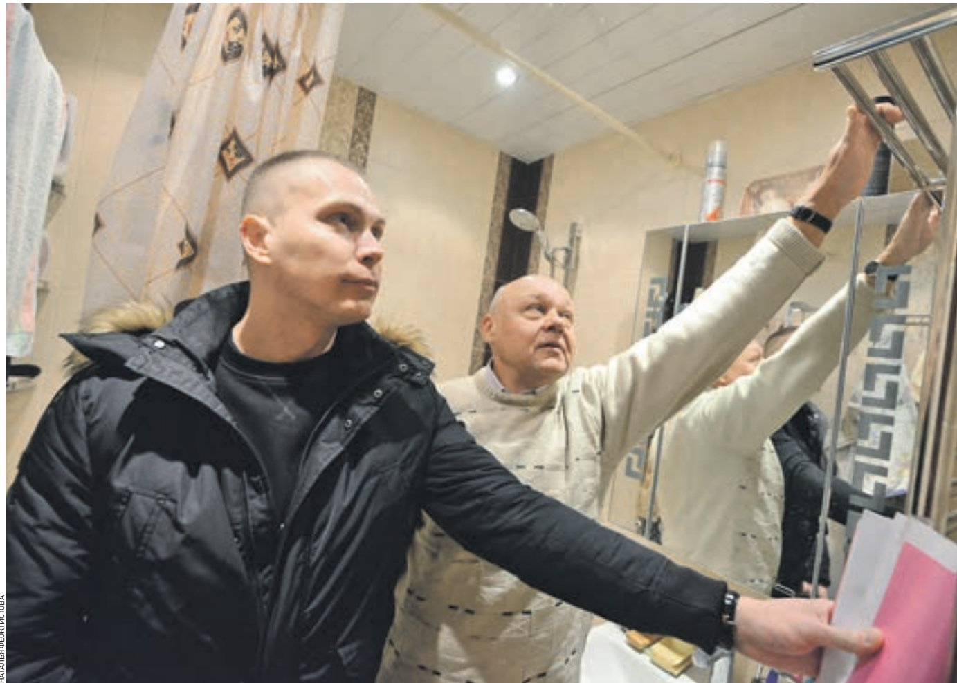
22 октября 13:20 Депутат Мещанского района Алексей Бондаренко (слева) и житель дома № 57, корпус 1, по Трифоновской улице Виктор Бакунин осматривают старые трубы холодного и горячего водоснабжения, которые не заменили в ходе капитального ремонта
