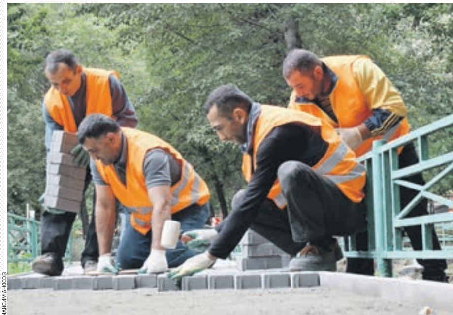
7 сентября 14:20 Рабочие кладут тротуарную плитку рядом с детской площадкой на 3-й Фрунзенской улице
