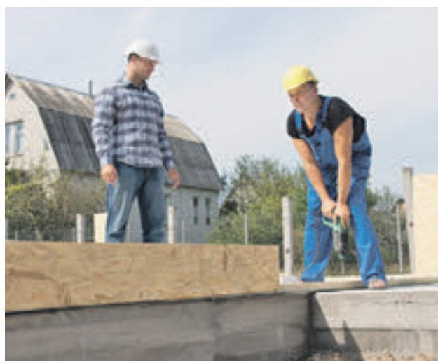
Возможные ошибки при строительстве фундамента могут повлечь за собой существенные денежные вложения, помните об этом
