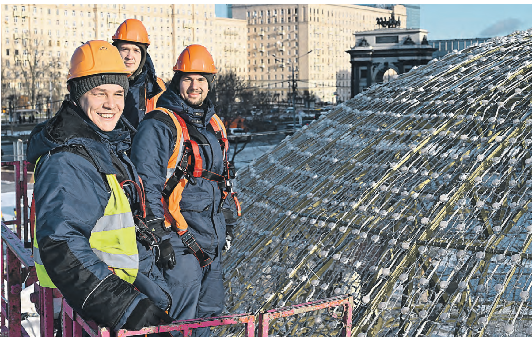
Вчера 11:50 Слева направо: монтажники Виктор Порфиленко, Роман Евтыхов, Владимир Флерко оформляют праздничную иллюминацию на гигантском новогоднем шаре на Поклонной горе. Установка этой конструкции будет завершена в ближайшие дни
