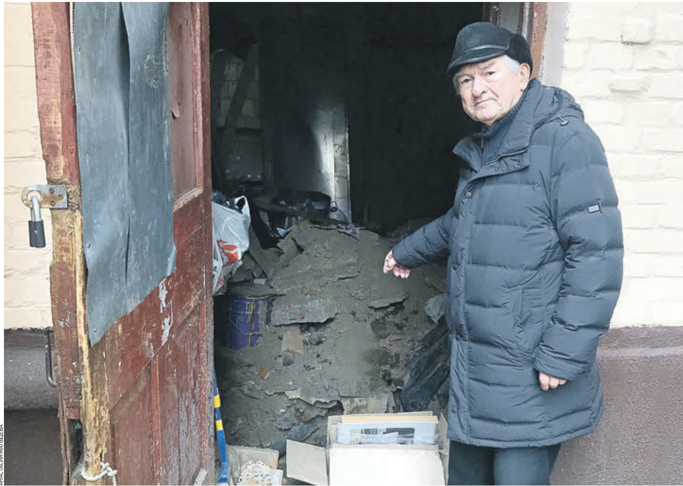
27 марта 2019 года 10:15 Житель седьмого подъезда дома № 36/2 по Фрунзенской набережной Михаил Бушуев показывает помещение неработающего мусоропровода. Через несколько дней, после вмешательства «ВМ», все неисправности были устранены
