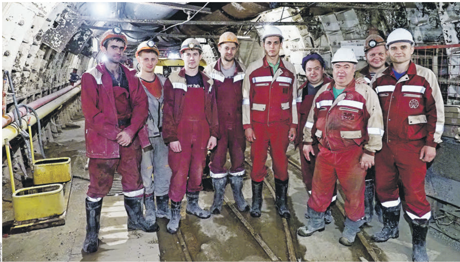
29 июля 12:07 Бригадир Александр Майоров (второй справа), горный мастер Сергей Травников (крайний справа), начальник участка Денис Гусаров (в центре) и бригад чеканчиков в тоннеле станции «Суворовская», которая должна войти в состав Кольцевой линии метро
