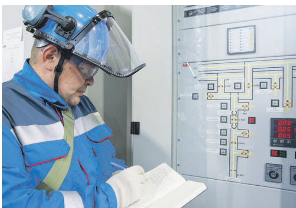
16 ноября 2017 года. Дежурный электромонтер Московского нефтеперерабатывающего завода осматривает оборудование подстанции 220 кВт «Капотня»
