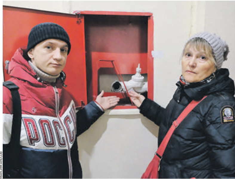
Вчера 11:24 Святослав Первов и Наталья Земляновская показывают, что в ящике на четвертом этаже подъезда № 14 нет пожарного рукава
