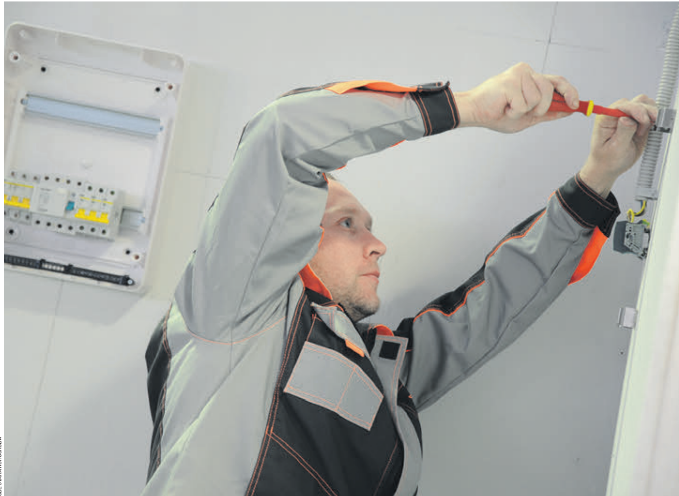
Вчера 12:15 Золотой призер Конкурса профессионального мастерства в сфере капитального ремонта, электрик Алексей Крутыко, выполняет задание по монтажу электропроводки и осветительных ламп
