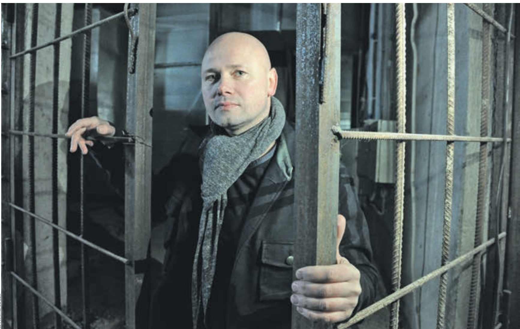
Вчера 13:10 Житель проблемного дома на улице Искры Руслан Соколов показывает, в каком состоянии находится помещение, которое должно быть подземным паркингом. Жильцам, создавшим товарищество собственников жилья, предстоит потрудиться, чтобы привести недостроенный дом в порядок
