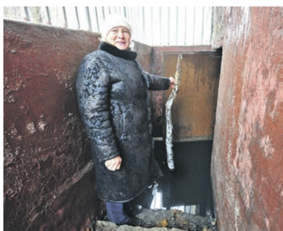
Вчера 11:10 Жительница дома №123А, корпус 26, по улице Профсоюзной Мария Рюмина жалуется, что подвал у них затоплен уже полгода
