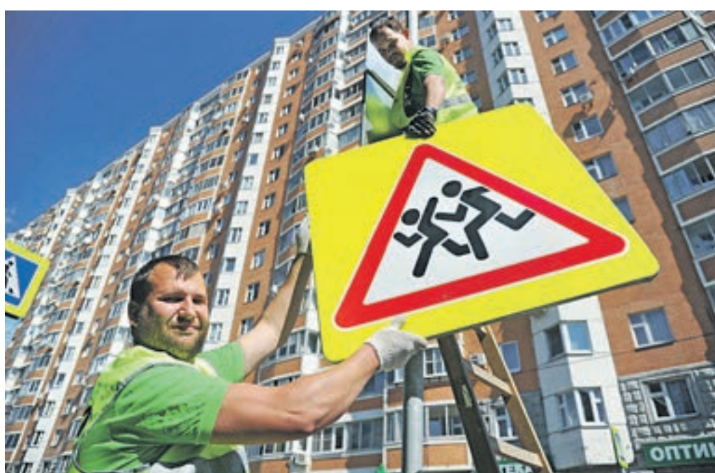
Вчера 13:17 Монтажники Центра организации дорожного движения Иван Москвичев (на переднем плане) и Сергей Расказов устанавливают знак у школы № 1862 на Артемовской улице
