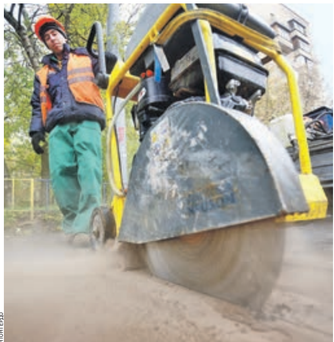
Вчера 12:30 Рабочий вырезает старый асфальт на месте подтопления в районе станции метро «Алексеевская»
