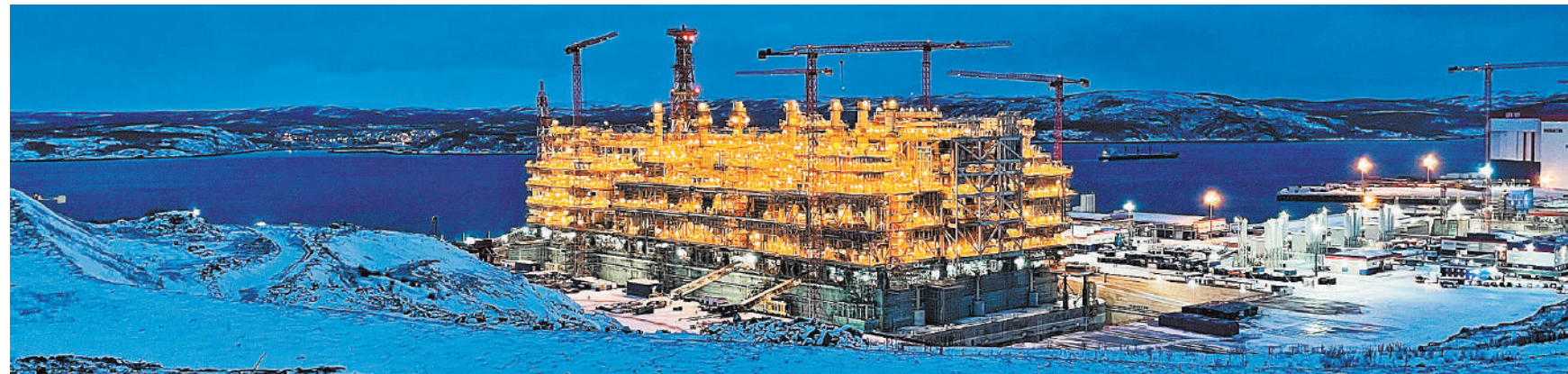
Сухой док ЦСКМС, где проводятся сборка, пуско-наладочные работы и подготовка к буксировке модулей для заводов по производству сжиженного газа.
