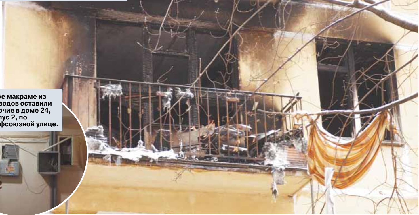
Такое макраме из проводов оставили рабочие в доме 24, корпус 2, по Профсоюзной улице.
