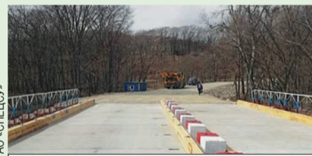
На трассе Владивосток - Находка восстановили проезд возле еще одного испорченного моста.
