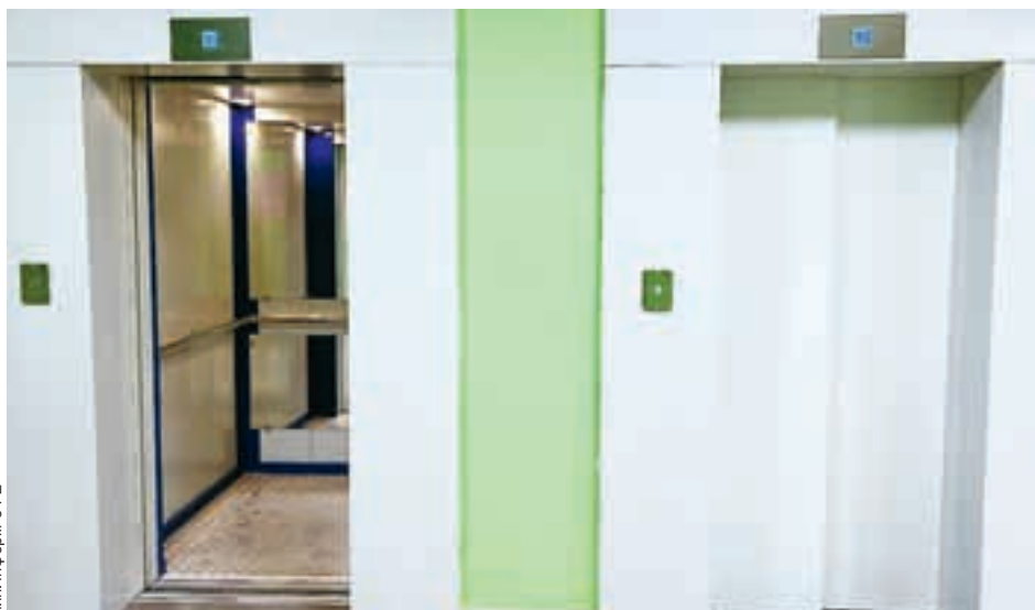
Главное требование к лифту - безопасное и качественное выполнение транспортной функции на протяжении всего срока эксплуатации.
