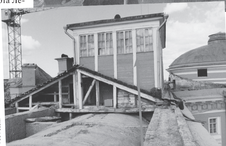
Веранда на крыше здания Сената, специально построенная для больного Ленина в 1922 году. Демонтирована в 1993-м.
