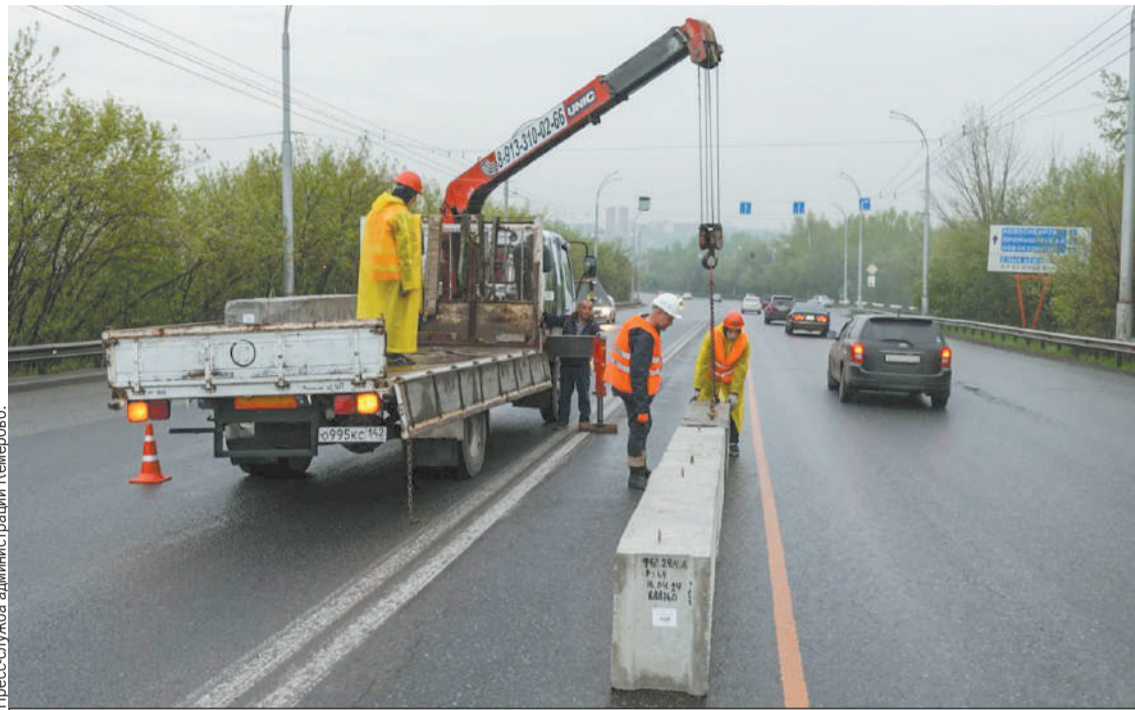
Ремонт Кузбасского моста начался в прошлом году - в подмостовом пространстве, в этом - работы уже необходимо проводить на поверхности.
